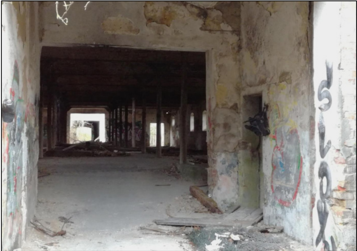
Abbildung 4-3: Blick von Norden in die Ruine der ehemaligen Stallungen (15.04.2021)
