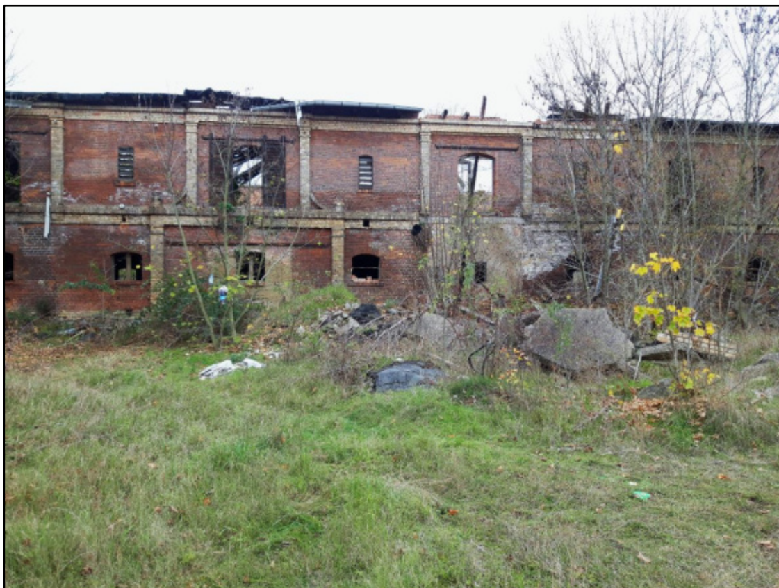
Blick Richtung Westen auf die Ruine des alten Kuhstalles (07.11.2022)
